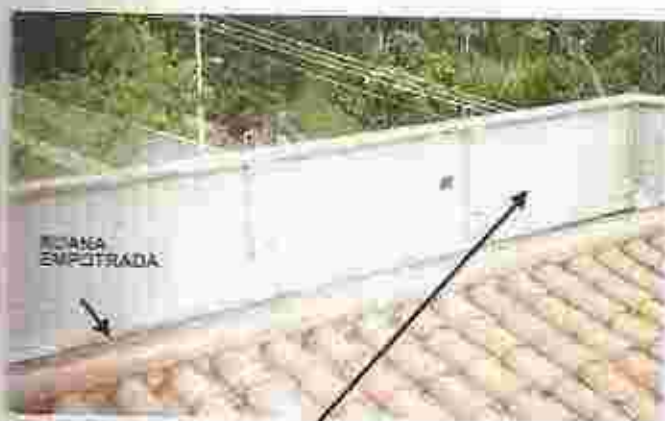
Esta cara requiere una impermeabilización que la cubra exterior o de fachada.
