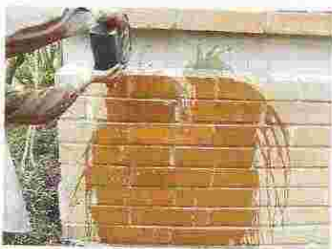
Ladrillos sin ninguna protección frente al agua.
