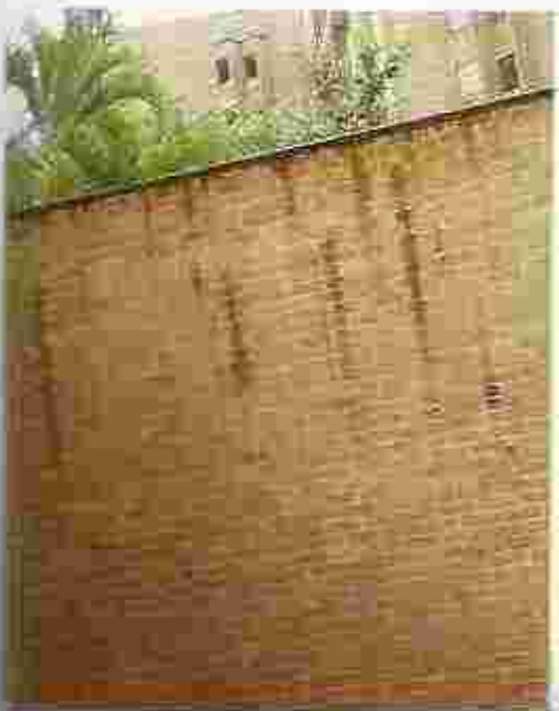
Permeabilidad de verticales por juntas de mortero.
