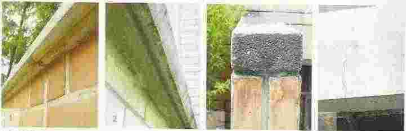
1 y 2. Detalle de cortado con bien definidos y acabados. 3. Sillar recto, asentado en un mortero permeable (si fuera impermeable no filtraría agua a la hilada inferior). 4. Fisura en un ladrillo vacado se conjugan la falta de juntas de dilatación y el exceso de retracción debida al exceso de agua en la mezcla.
