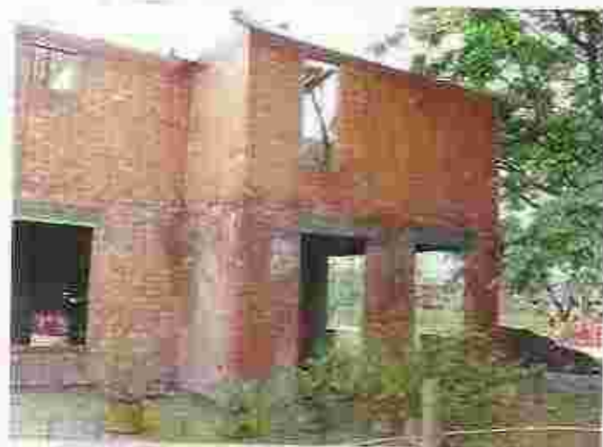
La obra se detiene por falta de techo.
