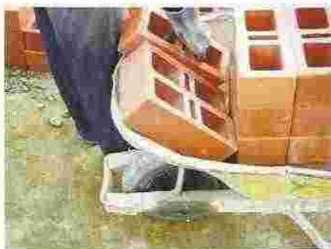
Transporte inadecuado en la obra: es preferible en cochinos planos, que no producen desbordes.
